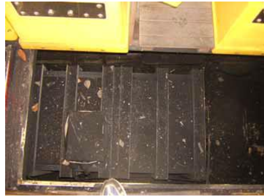
バッテリー区画(ハッチより見る)
