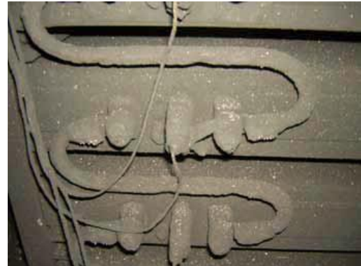
すずの付着状況(バッテリー端子部、配線)
