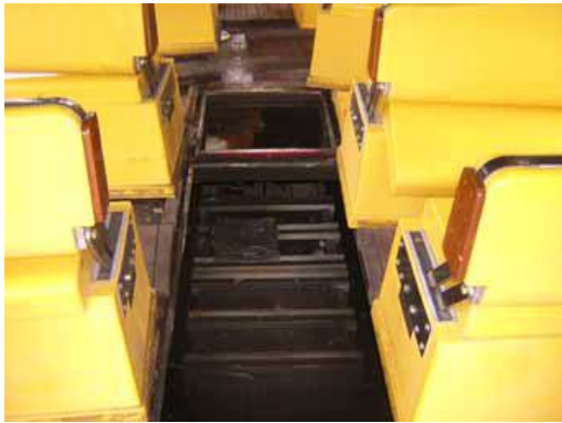
バッテリー区画(ハッチより見る)
