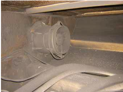
バッテリー区画の強制排気ファン
