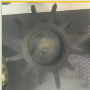
劣化が始まったインペラ
