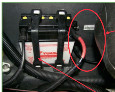
水素ガス排出ホース
